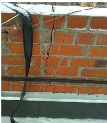
Рис. 1. Пример ошибки при возведении кирпичной кладки
