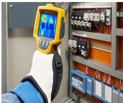
Рис.2 Применение тепловизоров для диагностирования электрооборудования ВРУ
