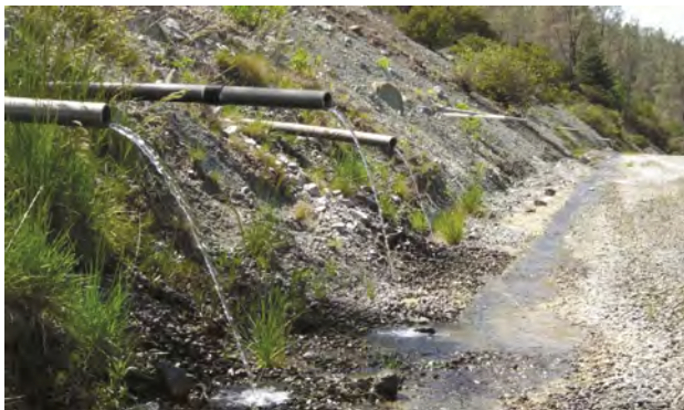
Рис.5. Дренажные трубы на склоне
