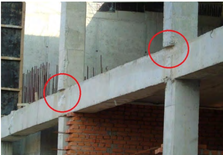
Рис. 2. Дефект монтажа железобетонных колонн
