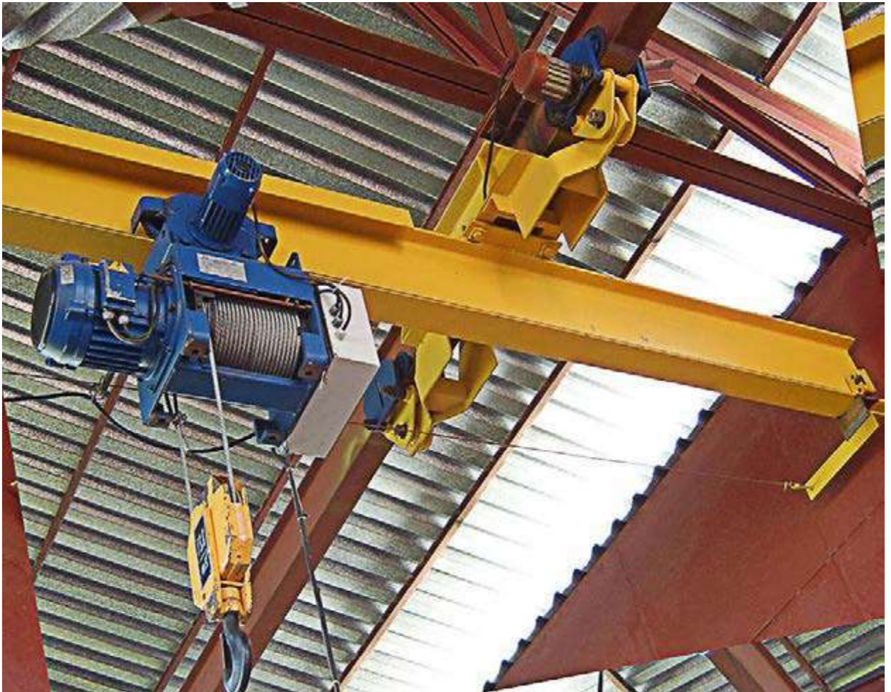
Рисунок 1.6 – Электрическая таль (тельфер) мостового крана
