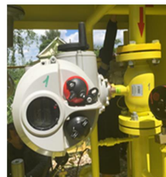
Рис. 11. Управление запорной арматурой в ШРП.
