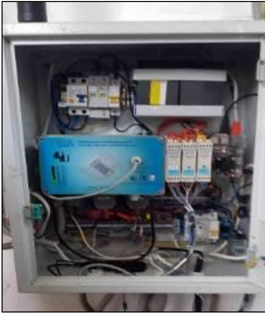
Рисунок 4.4 - Нейрокомпьютер (установлен в контрольном щите)
